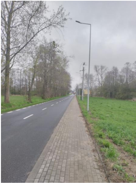
Fotografia. Oświetlenie uliczne w miejscowości Trzecianna
