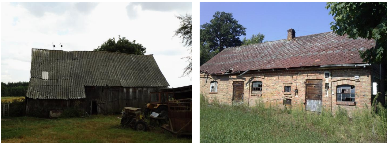
Rys. 1. Wyroby azbestowo – cementowe: po lewej płyty faliste, po prawej płyty płaskie, typ „Karo” (źródło: materiały własne)
